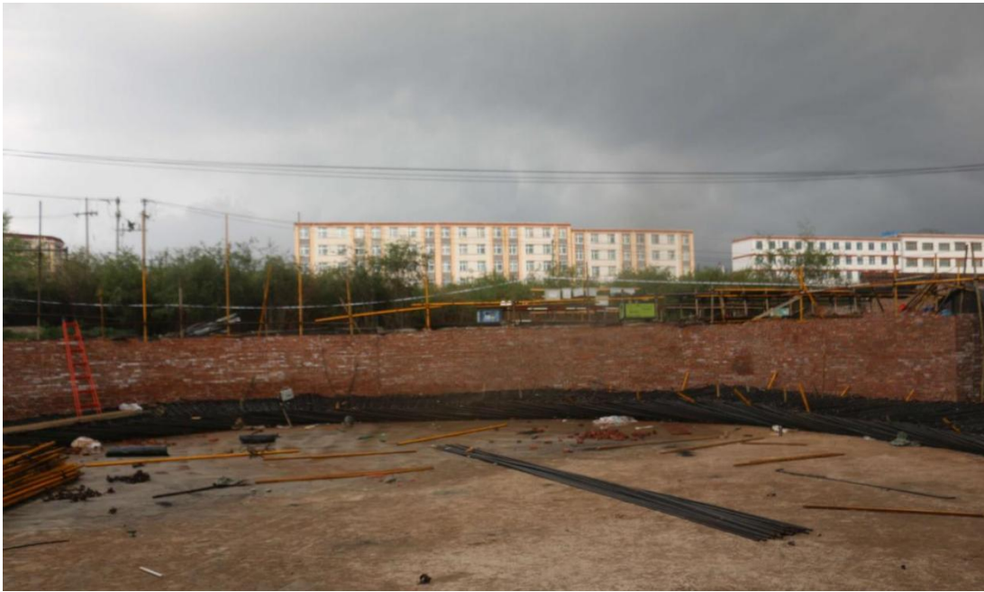
事故现场照片 1
